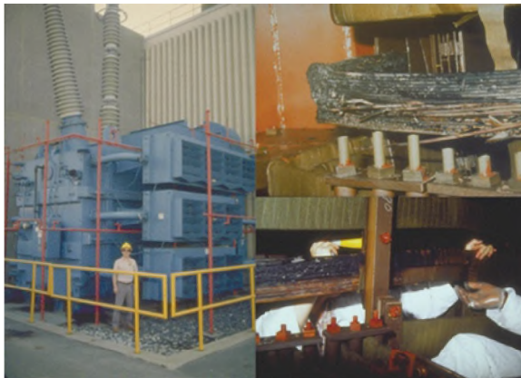
Рисунок 6.4 – Поврежденный вследствие наведенных во время геомагнитной бури токов трансформатор
