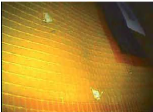
Рис. 3.27. Повреждения термозащитного одеяла под панелью радиатора
